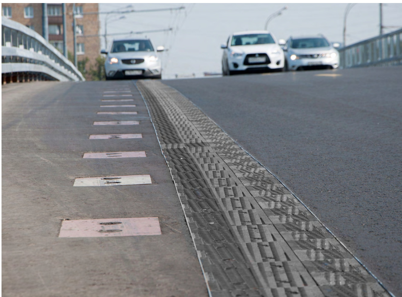
ЛВМ Bridge-Light, г. Москва, Волоколамское шоссе
