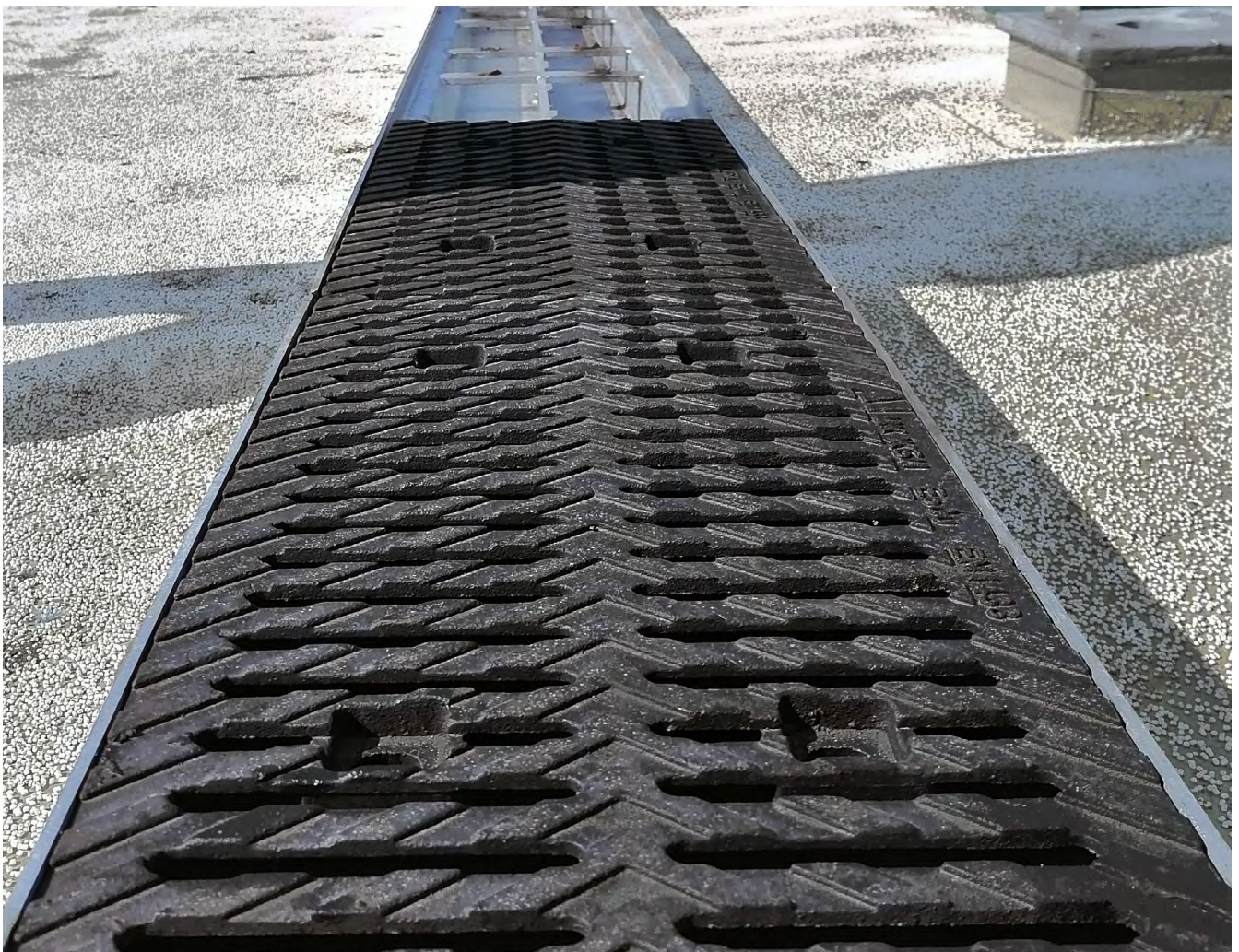
ЛВМ Bridge-Light, Татарстан, мост через р. Суксинка
