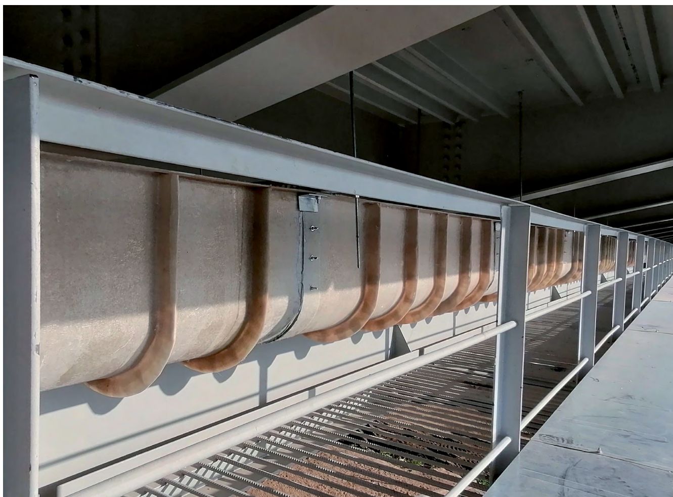
Лоток подвесной Bridgerplast, Ростовская область, трасса М4, мост через реку Черкасская
